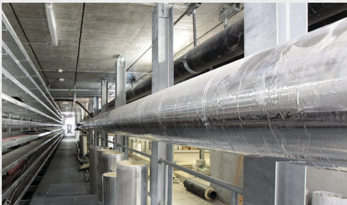
Aeroporto Internazionale di Ginevra – Tubazione antincendio (acqua fredda) DN 250 mm isolata con swissporKISODUR PIR Alu Lunghezza della condotta di spegnimento ca. 400 metri
