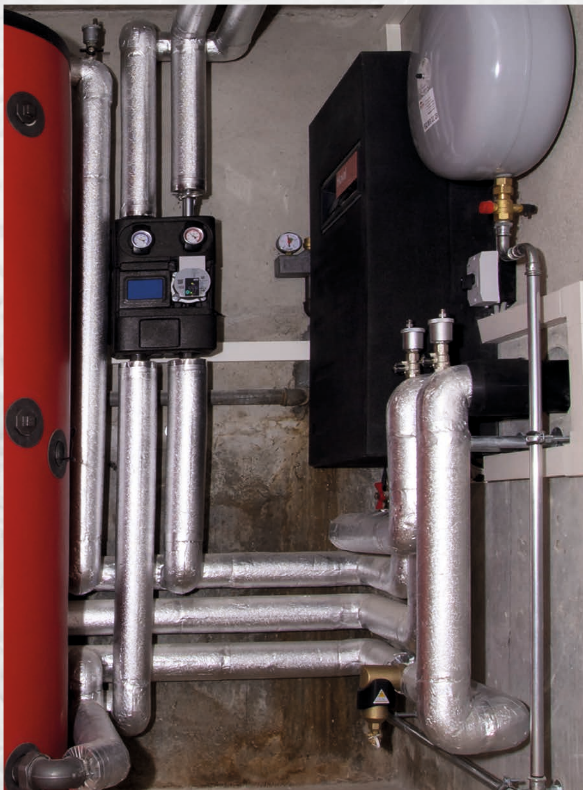
Locale caldaia privato a Neuchâtel – Impianto di riscaldamento e sanitario coibentati con swissporKISODUR PIR Alu goffrato
