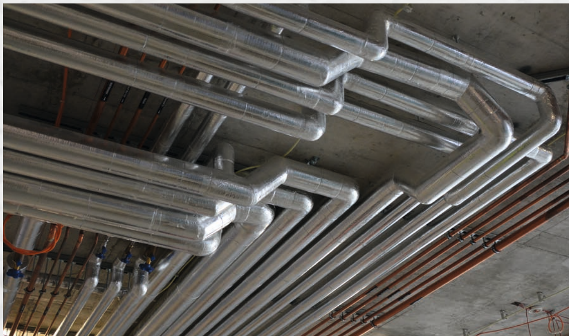
Ospedale cantonale di Winterthur – Impianti sanitari acqua calda-fredda coibentati con swissporKISODUR PIR Alu rinforzato
