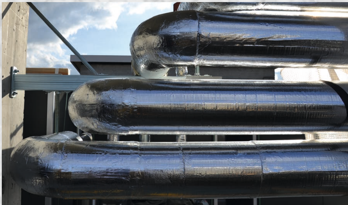
USI - Università della Svizzera Italiana Sistema di raffreddamento (6–12 °C) isolato con swissporKISODUR PIR Alu rinforzato
